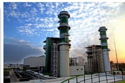
浙江长兴天然气发电有限公司
